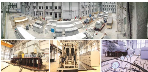
Рис. 5 Электротехнический стенд мощностью до 40 МВт
