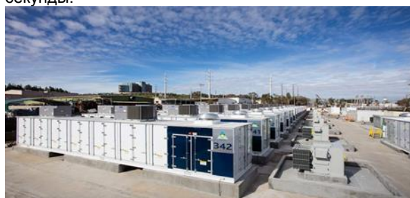
Рис. 7. Литий-ионный накопитель SDG&E (Калифорния, 2017 г.) 30 МВт, емкость 120 МВт·ч.
