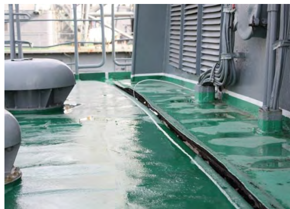
Рис. 2. Трещина в палубе надстройки корабля, возникшая во время сильного шторма [4]
