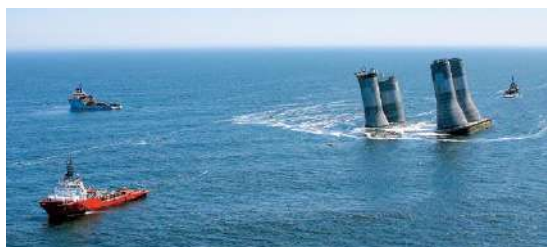
Рис. 1. Затопление железобетонного основания платформы «Лун-А» в июле 2006 в 15 км от Сахалина на глубину 48 м [3].
