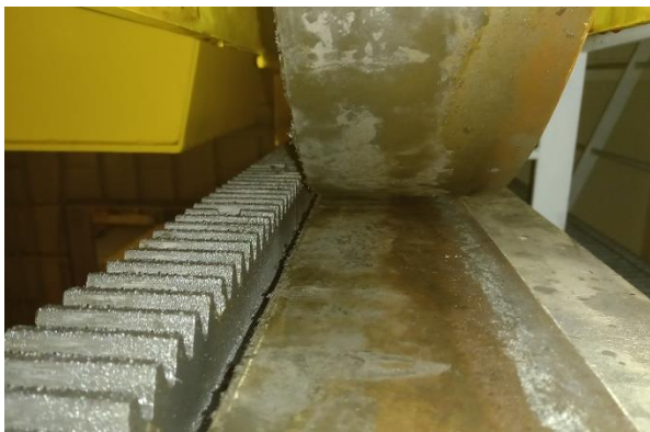
Рис. 12. Характерный износ кранового пути и опорного колеса мостового крана
